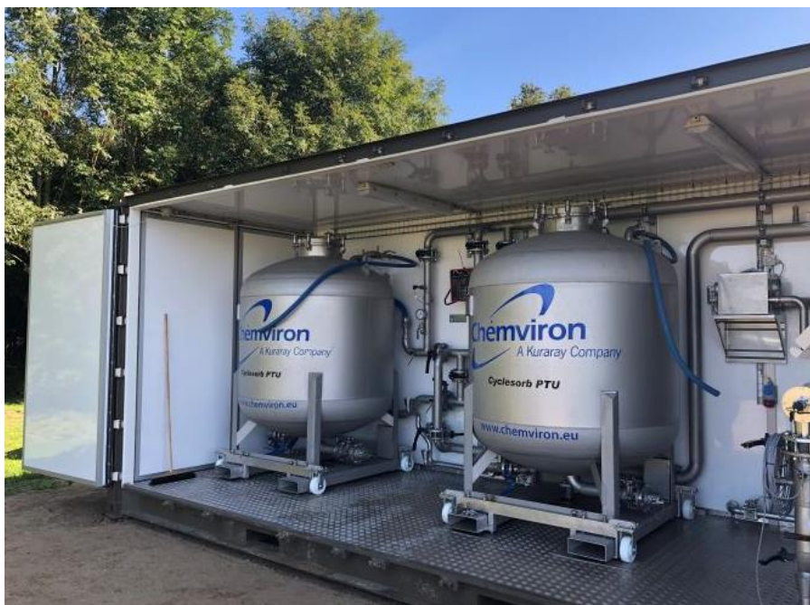
Fig. 1. Den container VCS har opstillet i skoven med kulfilteranlægget til vandrensning af boring V7.
